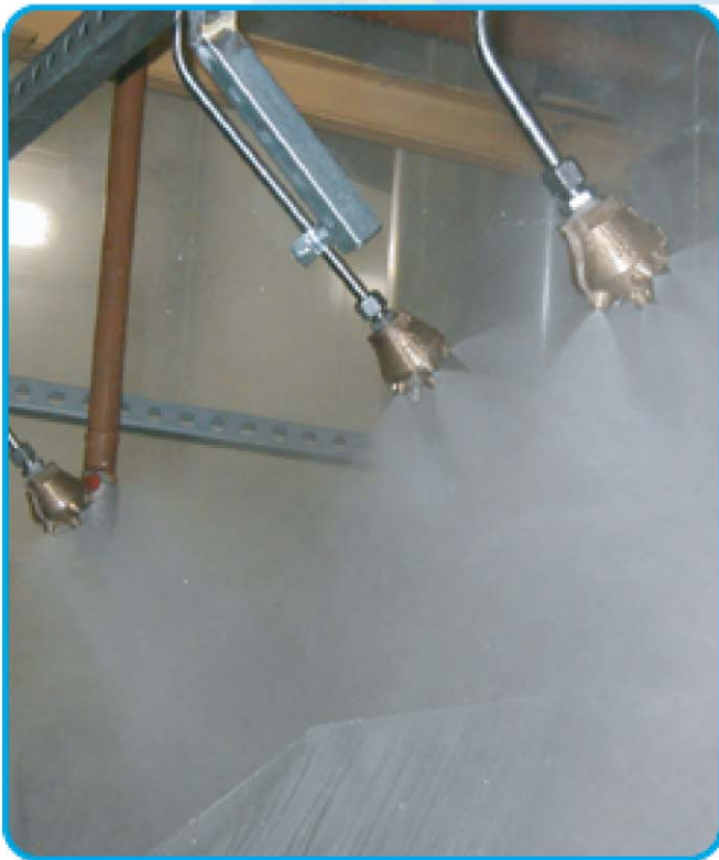
Protection ponctuelle d'un groupe électrogène
